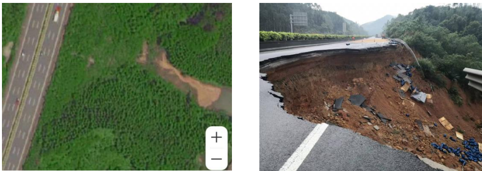
说明图 3 薄填处渗透破坏导致路基塌陷
