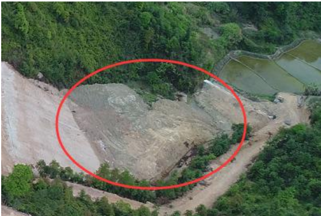
附图 4 弃土场挡土墙
